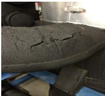
Kondenzácia a korózia
